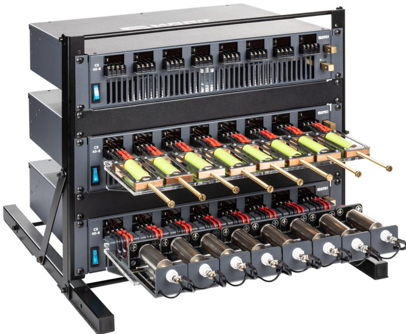
Пример установки цилиндрических аккумуляторов в двухточечных держателях ВН-3 (сверху, зеленые аккумуляторы 18650). Циклеры CS-40-8 (8 А на канал) в настольной стойке.
